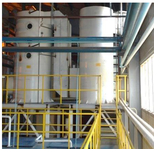
Рисунок 3 – Очистка вентвоздуха от пресса ДСП фирмы «Диффенбахер». АБХУ эксплуатируется с 2012 г.
