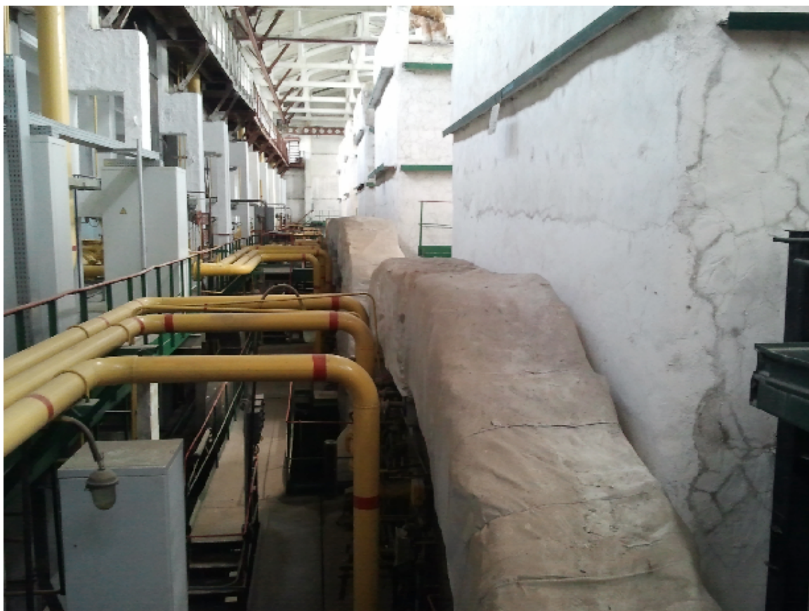
Рисунок 1 – Котлы КВГМ-100 на котельной «Южная» (г. Витебск)
